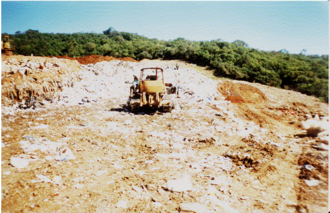
FIGURA 21: Antigo lixão de Sant'Ana do Livramento - RS, ultimamente transformado em "aterro sanitário". Data: 09/2002.
