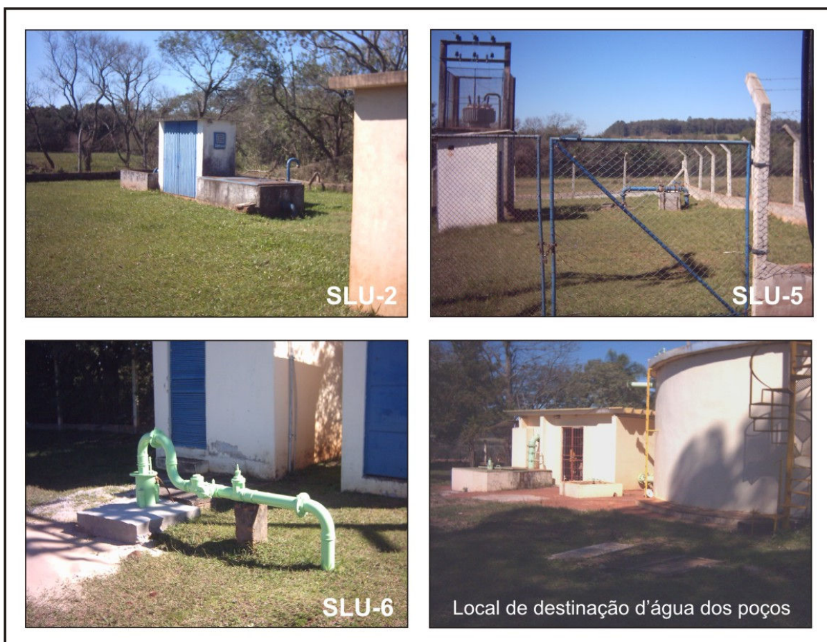
Figura 12 - Poços da CORSAN que atingem o Aqüífero Guarani. Fonte: Trabalho de campo (2006).
