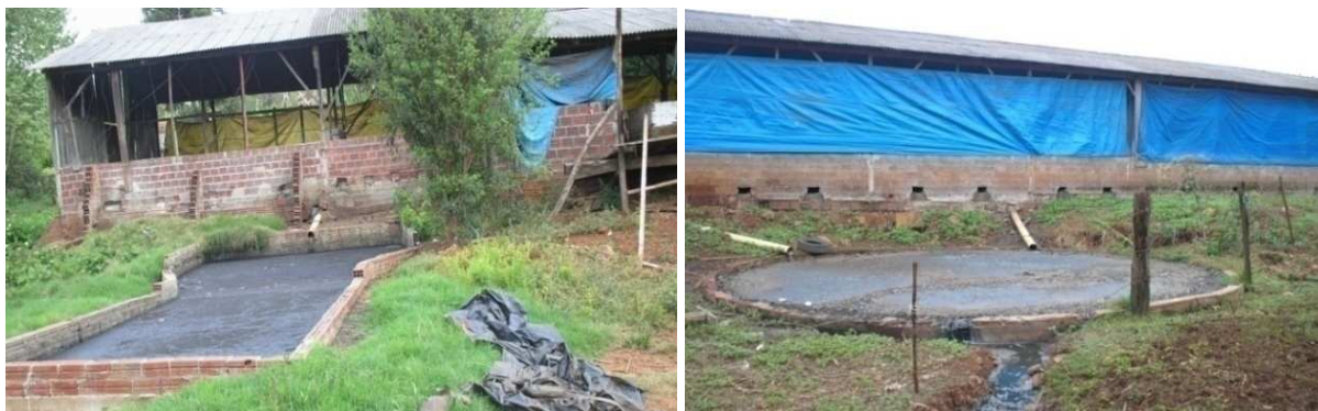
Figuras 17 e18 – Extravasamento de dejetos em duas esterqueiras. Fotos: CAPOANE, V.
