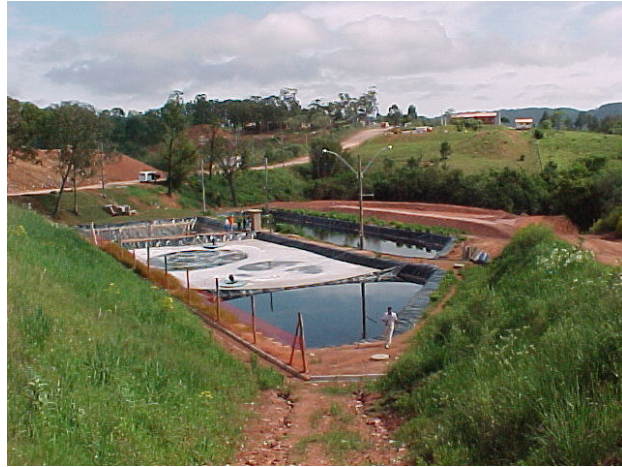
Sistema de tratamento de lixo por lagoas de estabilização Aterro Sanitário Santa Tecla - Gravataí
