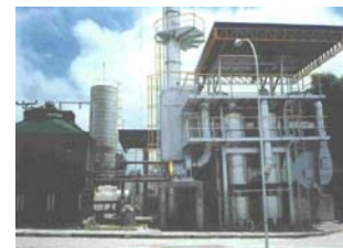
Centro de Tratamento de Resíduos Perigosos – Fortaleza, Ceará – Sistema de tratamento de gases
